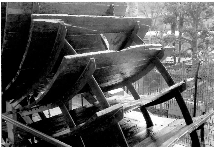
■大きく破損した「元氣くん1号」の羽根。木製のためにすぐ取り換えられ、稼働にはあまり支障をきたしませんが、なるべくならばこうした状況は避けたいものです。
