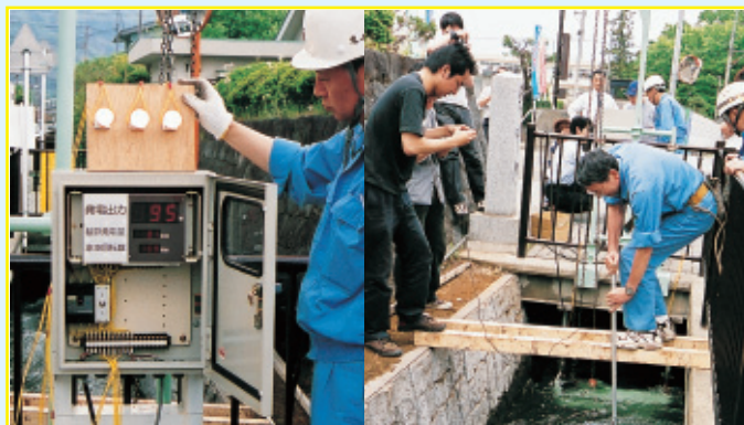
家中川を利用した水力発電 サボニウス型水車によるマイクロ水力発電の第2期実験が開始されました。水車に改良を加え、実用化に向けてのデータ収集・研究が行われます。
